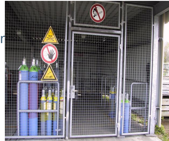
Flaschenlager in einem separaten Raum
